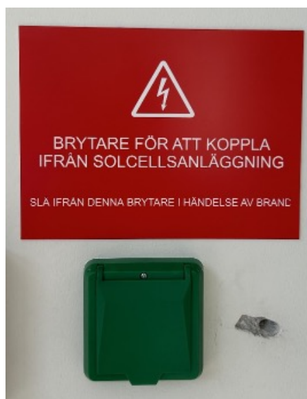
Figur 5 Manöverdon till DC-brytare med skyltning
